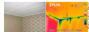
Luftläckage vid anslutning mellan yttervägg och tak i sovrum.
